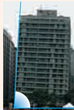
Fachada de prédio inclinado na orla de Santos, SP, 2013.
