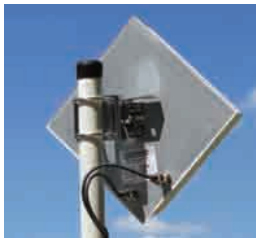
Antena para redes de comunicação móveis.
